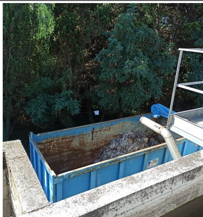
Foto n. 1: Contenitore per grigliato ingresso impianto.
